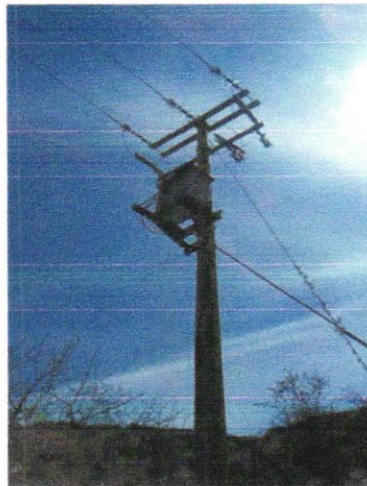
Vista del transformador funcionando
